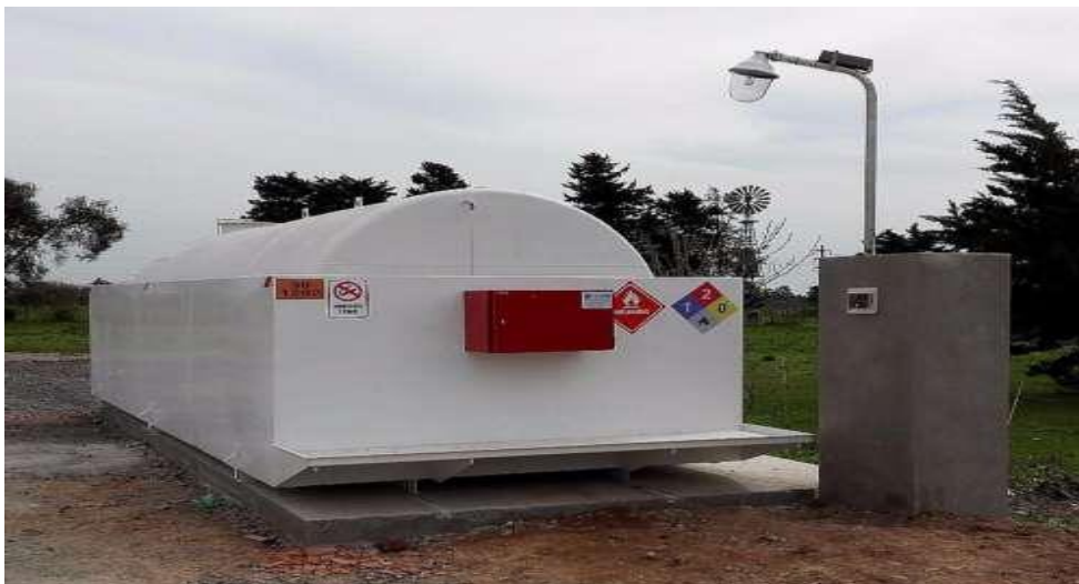
Figura 6-20 Almacenamiento de combustible con dique integrado.
